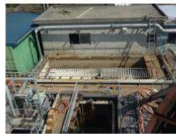
食品工場の排水処理設備
