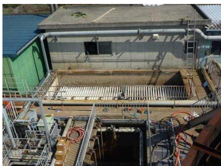
食品加工場の排水処理設備
