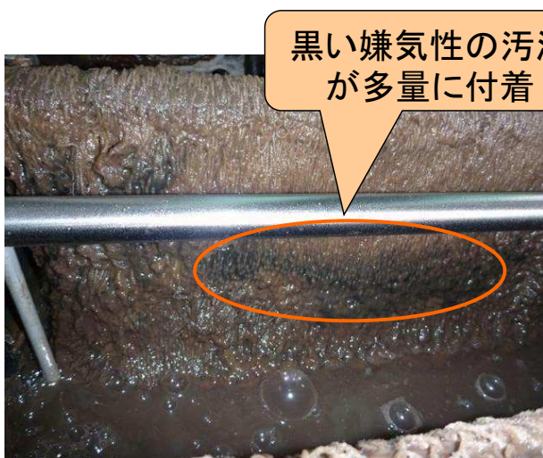
活性汚泥槽に設置した場合の 微生物の付着
